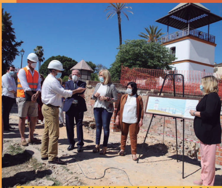
Profunda remodelación del Auditorio de la Casa de la Cultura financiada con fondos de la Diputación de Sevilla.
